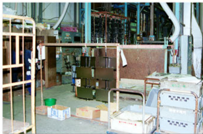
全自動ニッケルメッキ装置 1号機
