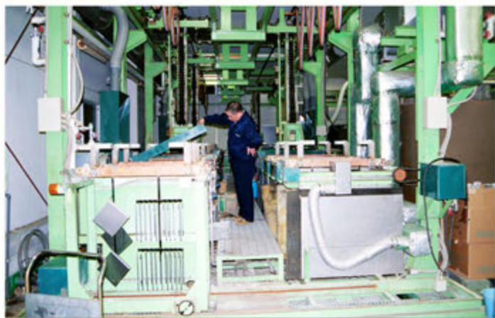
全自動ニッケルメッキ装置 2号機
