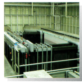
アノダイズ設備 Anodization Facility
